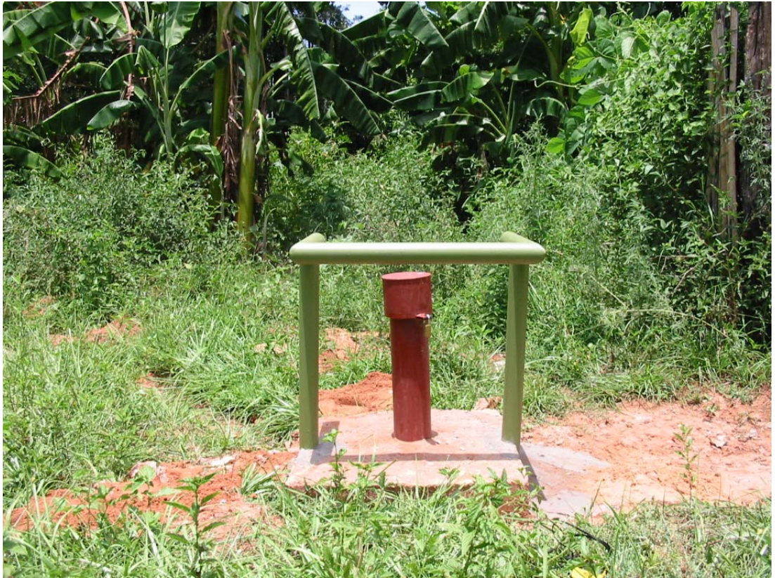
Piezómetro Escuela Potrero Poi
