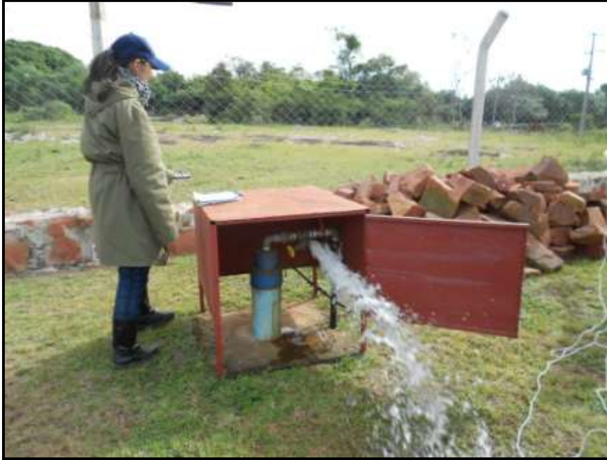
San Juan Bautista – Junta de Saneamiento de San Cristóbal, registro de características del pozo tubular profundo, toma de muestra para análisis de laboratorio. Tanque y Caseta de la Junta.
